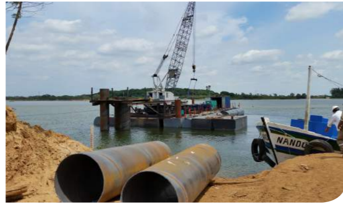
Ponte de São João da Barra Local: São João da Barra, RJ Produto: Camisas metálicas
